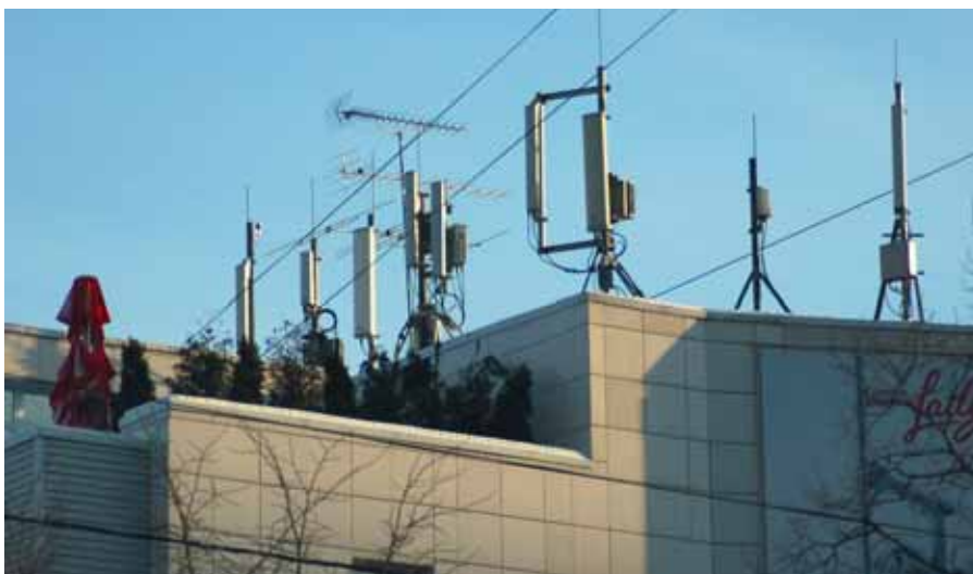
► Антенны сотовой связи в Москве (фото автора). Тонкий штырь сверху на каждой антенне — радиорелейная связь между базовыми станциями на частоте 3—40 ГГц. На снимке видны также три ажурные конструкции из тонких стержней — компоненты коллективной приемной антенны аналогового телевидения
